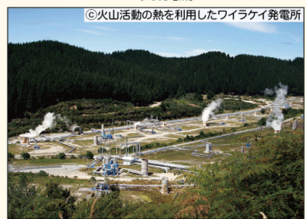
◎火山活動の熱を利用したワイラケイ発電所
